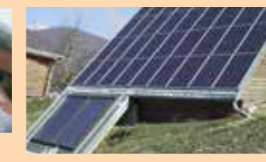
Plan vitré thermique et modules photovoltaïques
